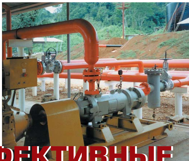
Фото 1. Трехвинтовой насос Ito с дизельным приводом на магистральном трубопроводе сырой нефти в Центральной Америке
